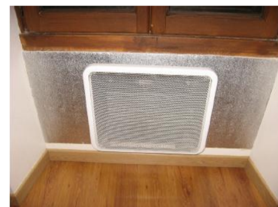
Panneau réfléchissant derrière un radiateur
